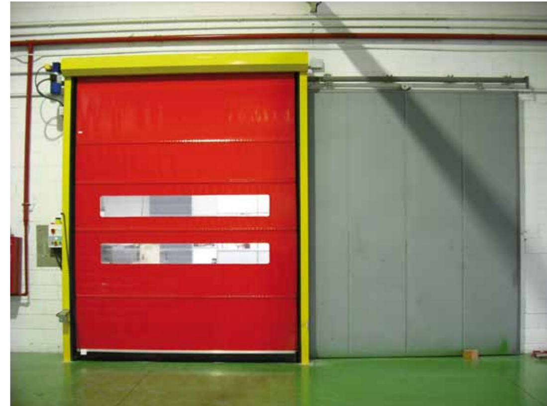
Conjunto puerta cortafuegos con rápida.
